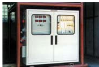
Steuerung für Außenanlagen
